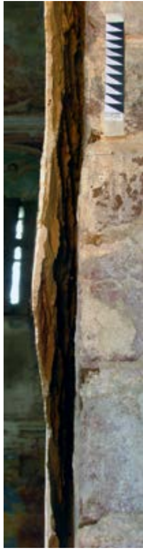
Ил. 4. Отставание штукатурного слоя от кирпичной кладки Fig. 4. Delamination of the plaster layer from the masonry
